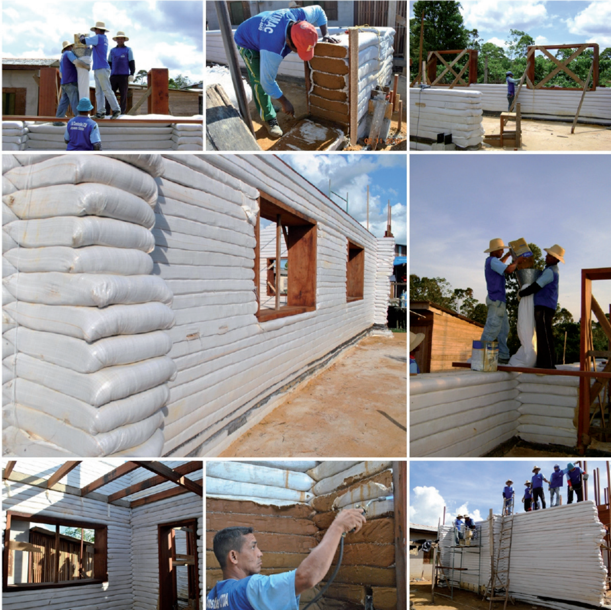
Figura 3 – Registro fotográfico da execução da taipa ensacada (superadobe) durante construção da Base Administrativa da Reserva Biológica do Lago Piratuba localizada na cidade de Cutias/AP.
