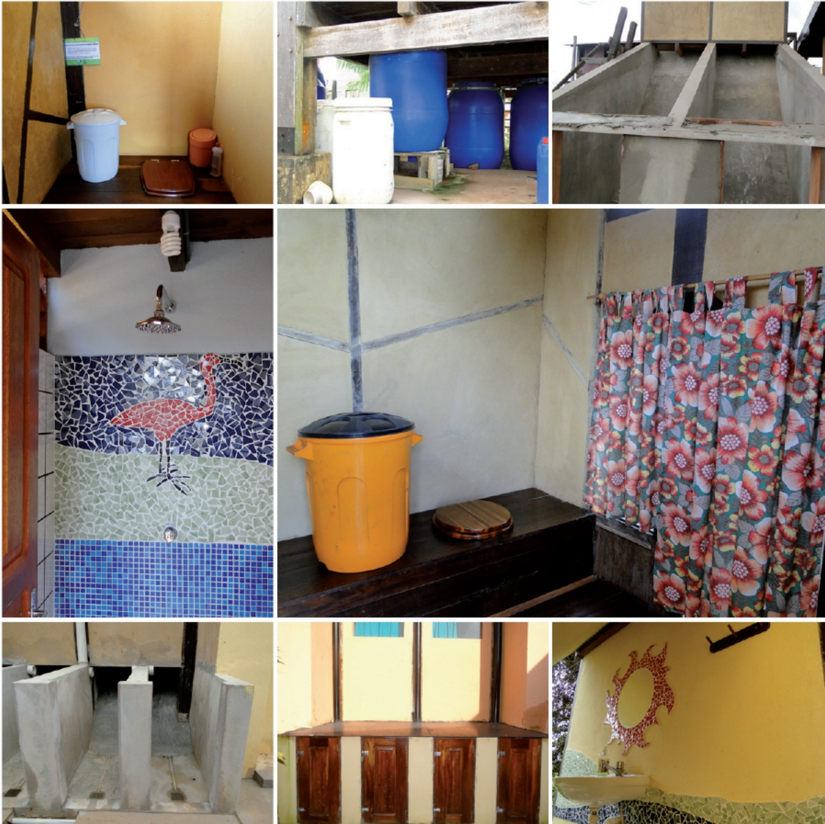
Figura 6 – Registro fotográfico dos sanitários secos (de duas câmaras e com utilização de tonel plástico) e chuveiro e pia do módulo externo do sanitário da Base Administrativa da Reserva Biológica do Lago Piratuba localizada na cidade de Cutias/AP.
