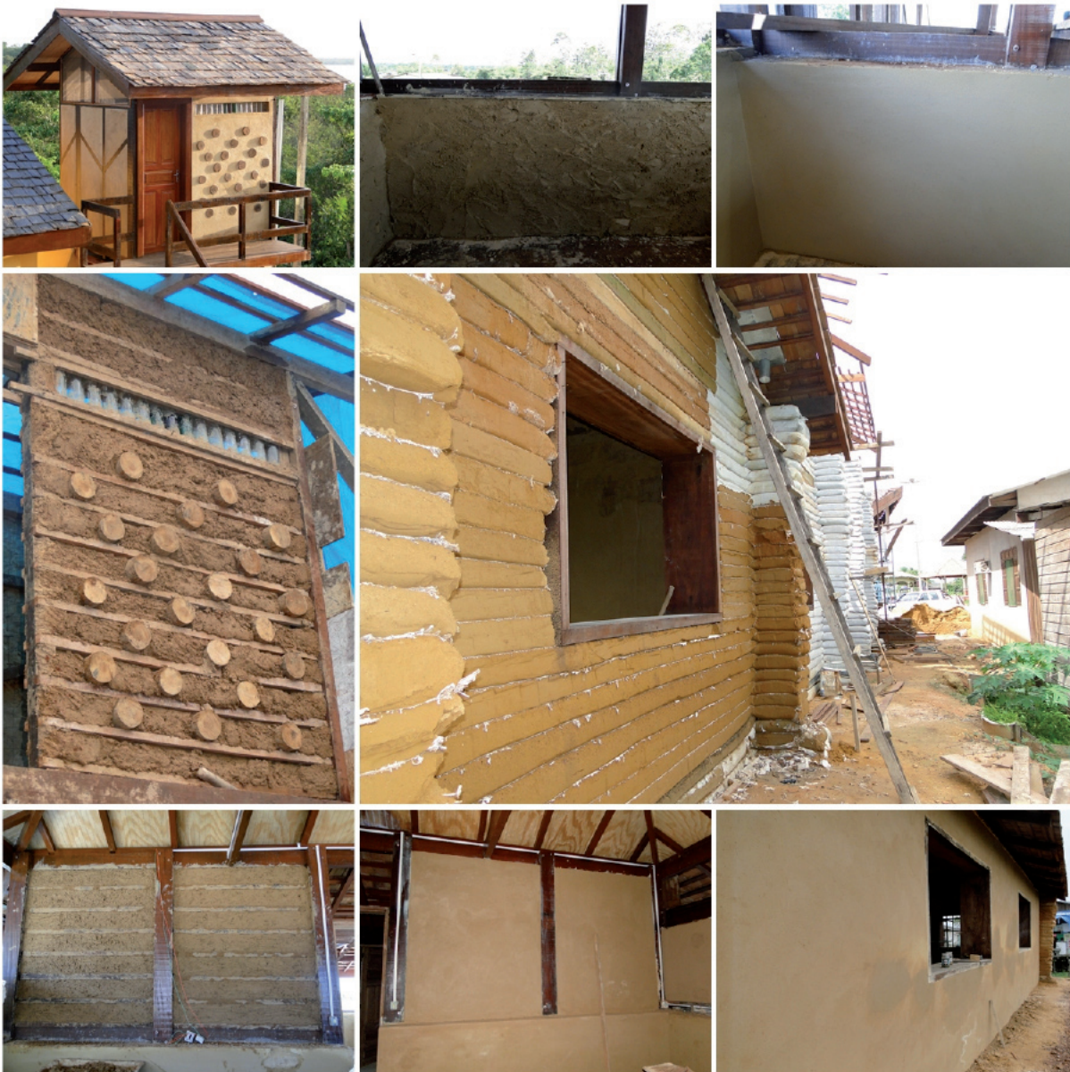
Figura 8 – Registro fotográfico da execução de reboco natural nas paredes de taipa ensacada e taipa de mão durante construção da Base Administrativa da Reserva Biológica do Lago Piratuba localizada na cidade de Cutias/AP.
